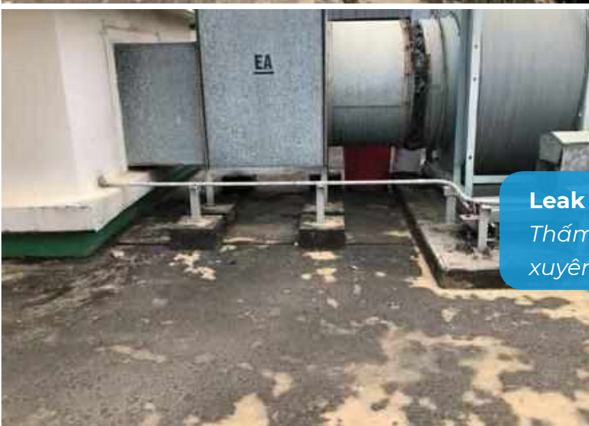
Leak in the gutter Thấm tại máng xối
